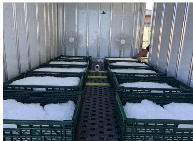
図-10 雪冷媒を床に平置き設置した状態
